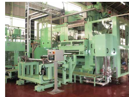
LiB製造の原反工程で使われるロールプレス設備 (株)日立パワーソリューションズ製
